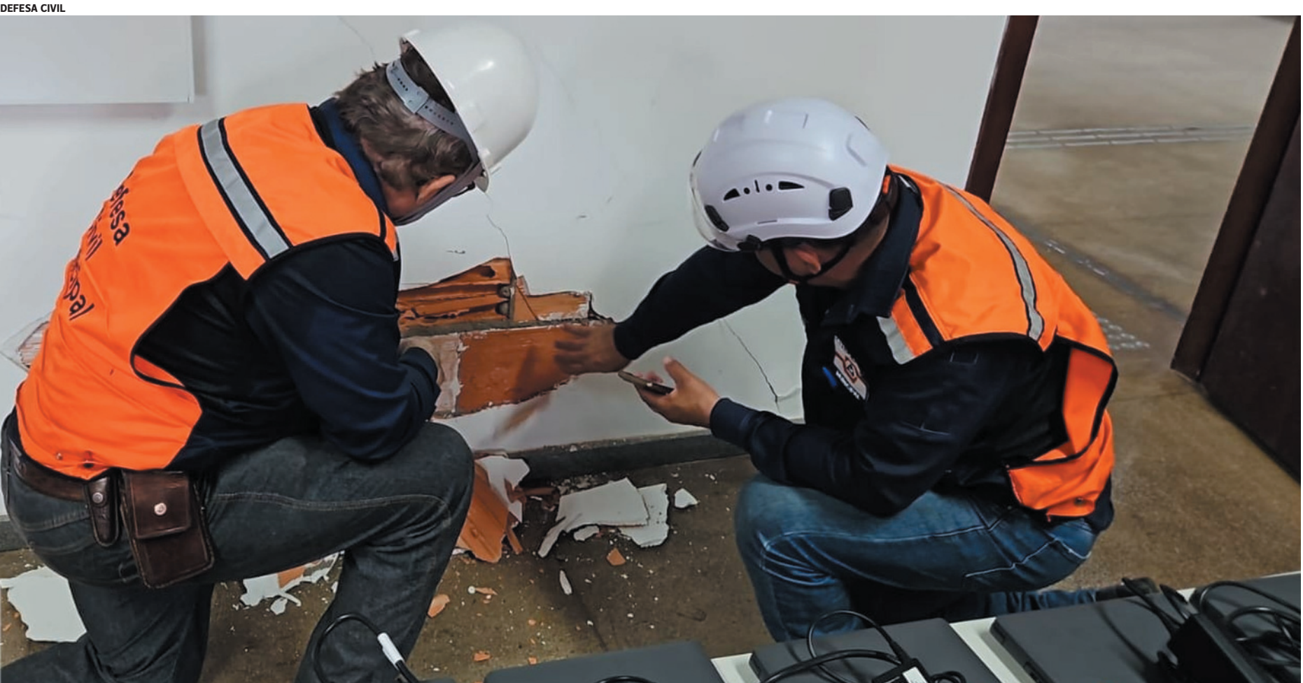
Em observação, prédio do Ibituruna foi construído pela Construtora Turano, a mesma responsável pelo Edifício Roma, interditado em 2024 por danos nos pilares
