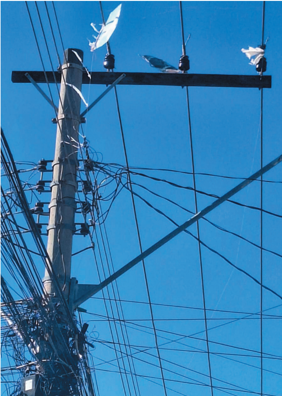
Soltura de pipas provoca interrupção de energia e pode resultar em acidentes mais graves
