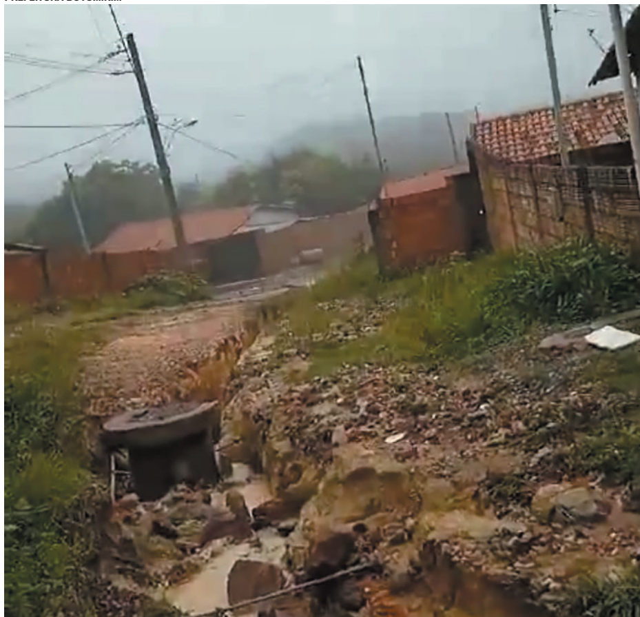
Em Botumirim, as estradas estão comprometidas e o adiamento do ano letivo é uma necessidade dos gestores
